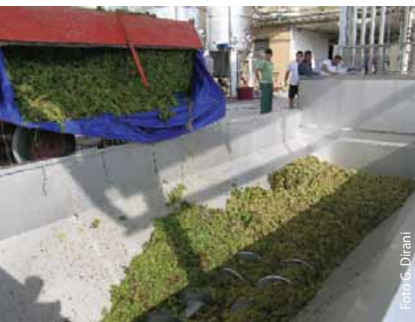
(C) - La tramoggia di ricezione funziona con una o più coclee. Nel caso non sia presente un'adeguata protezione fisica, può essere presente un dispositivo elettronico che arresta l'impianto in caso di caduta accidentale
