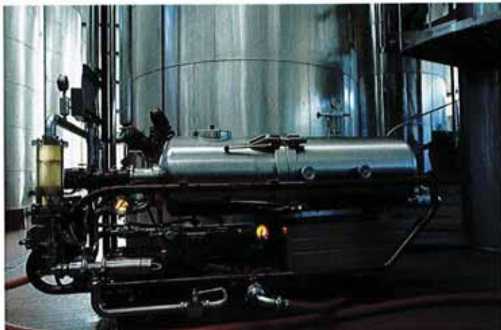
A sinistra: Filtro a farina mod. Victoria impiegato negli anni '60-'80 - Padovan
